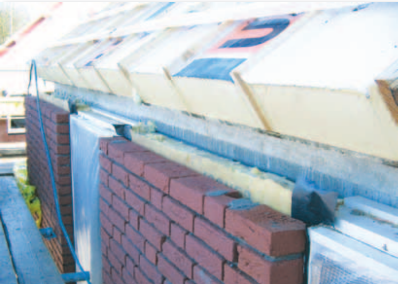
Foto 1: Aansluiting dakelement/gevel. De isolatie in de gevel dient strak aan te sluiten op de isolatie in het dakelement. Vaak worden hiervoor losse isolatiestroken (vulstukken) op het hoekpunt aangebracht.
