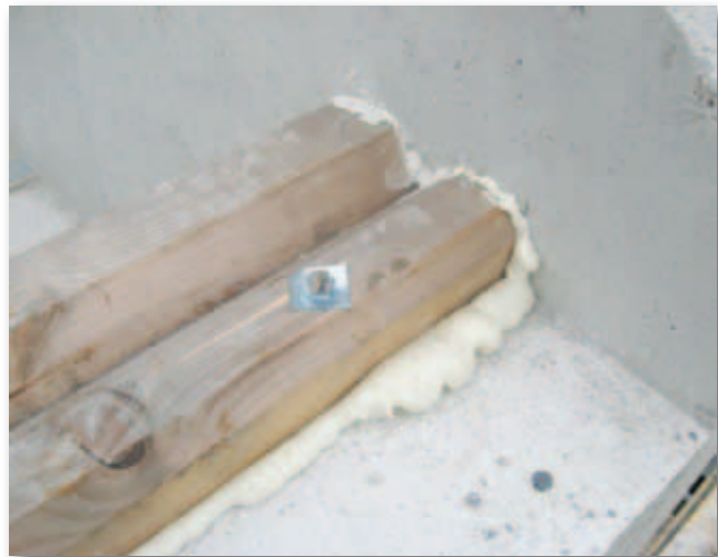
Foto 2b: De derde dichting bevindt zich tussen het eind van de muurplaat en de kopgevel/bouwmuur. Deze dichting moet aansluiten op de beide andere dichtingen. In dit geval is te weinig ruimte voorzien waardoor geen goede pur-dichting is aan te brengen.
